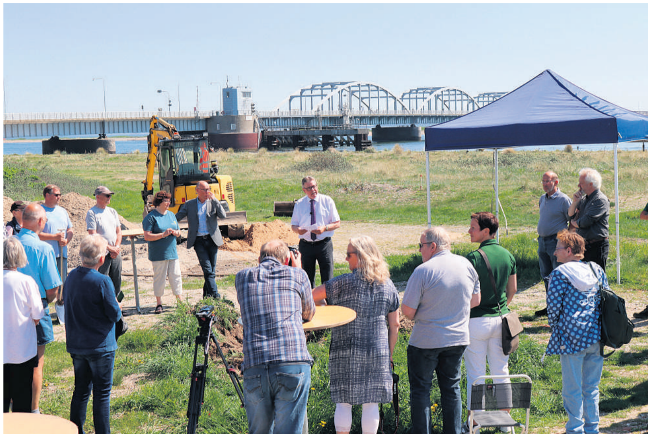
Borgmester Niels Viggo Lynghøj (S) kunne mandag middag tage det første spadestik til byggeriet af et nyt oplevelsestårn ved Oddesund. Foto: Christian Møller Nielsen
